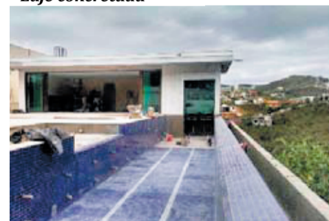
Todas as tubulações prontas
